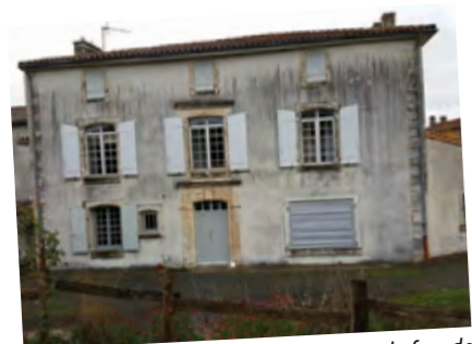
Changements de volets et de la porte sur la façade arrière de la mairie
